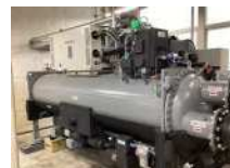
ターボ冷凍機 冷房能力：879.1kW
