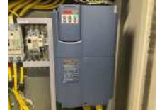
空調機変風量制御 (INVユニット)
