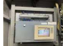
ポンプ推定末端圧制御 (コントローラー)
